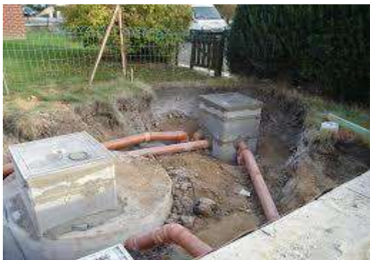
Chambre de visite extérieure
